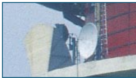
Bild 2: Gefahr nur für Techniker, die daran arbeiten: Richtfunkantennen strahlen sehr gerichtete Energie in sehr hohen Frequenzbereichen ab. Hier wirkt im (Un-)Fall vor allem der thermische Effekt.
