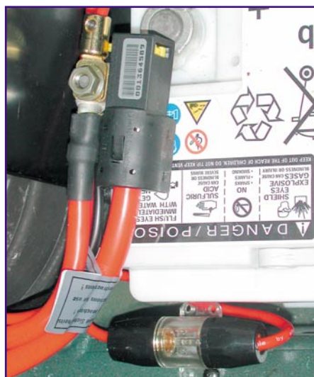
Bild 31: Hier ist größte Sorgfalt angesagt: Anschluss der Plusleitung an der Batterie. Unten der Sicherungshalter.
