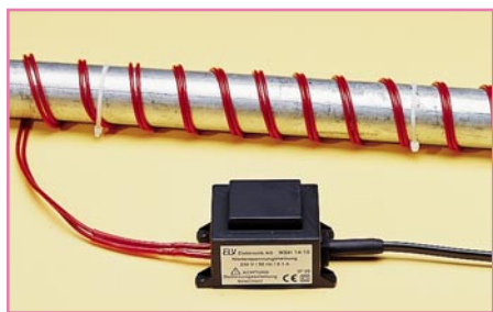
Bild 7: Heizleitung der NSH 14-3/14-10, an einer Wasserleitung montiert
