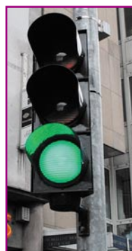
Bild 15: Besser sichtbar, zuverlässiger, wartungsarm und kostengünstig – die Umrüstung deutscher Städte auf LED-Ampeln beginnt. Foto: SIEMENS
