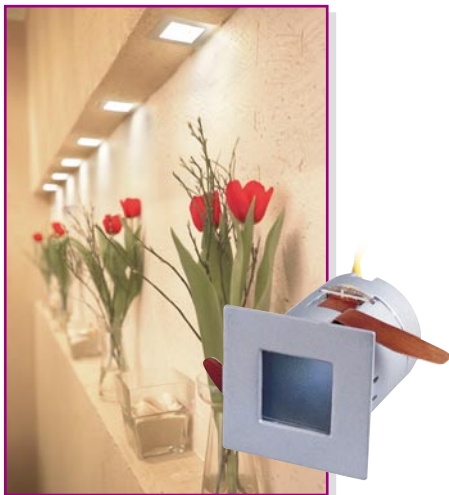
Bild 27: Elegantes Ambiente mit LED-Einbauleuchten
