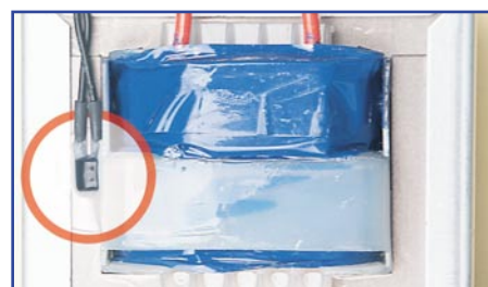
Bild 56: Befestigung des Temperatursensors am Netztrafo
