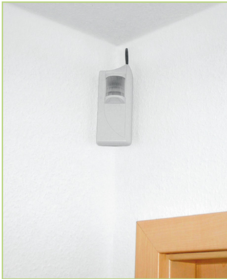
Bild 13: F20-PIRI-Bewegungsmelder sorgen für ökonomischen Beleuchtungsbetrieb in Diele und Flur.
