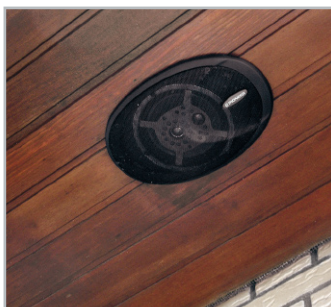
Bild 14: Geschützt untergebracht: Deckenlautsprecher in der Terrassenüberdachung
