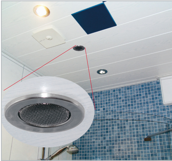
Bild 11: Deckenlautsprecher-Montage im Bad. Die Lautsprecherabdeckung hat das gleiche Design wie die Halogen- bzw. LED-Leuchten.
