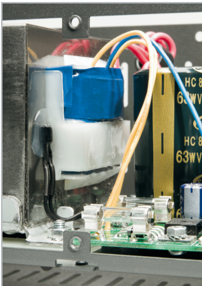
Bild 17: Befestigung des Temperatursensors am Trafo
