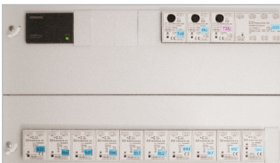
Bild 2: Die HS485-Komponenten sind im Sicherungskasten und den Etagenverteilern eingebaut, hier ist u. a. oben rechts das Universal-I/O-Modul HS485 I0127 zu sehen.
