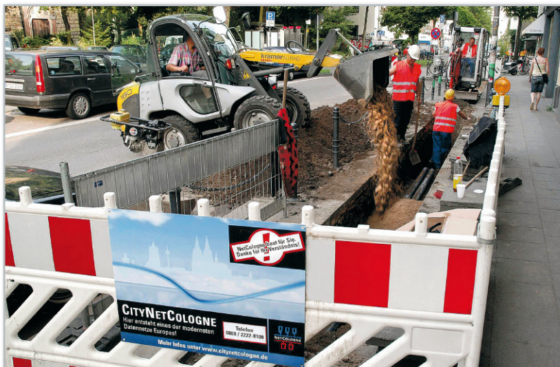
Bild 13: In Köln werden nach dem Glasfasernetzausbau bis in die Gebäude hinein 100 Mbit/s und mehr für den Teilnehmer verfügbar sein. Dagegen fehlen in den meisten Fällen leistungsfähige Verteilungsanlagen in den Wohnungen.
