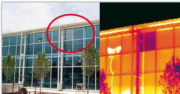
Bild 4: Baumangel schnell entdeckt: Die Thermografieinspektion deckt falsch eingebaute Fenster auf. Die Beschichtung ist innen statt außen am Fenster angebracht. (Bilder: FLIR)
