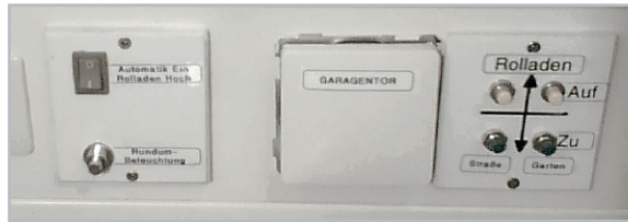
Bild 7: Die zentralen Bedienelemente für Licht- und Rolladensteuerung
