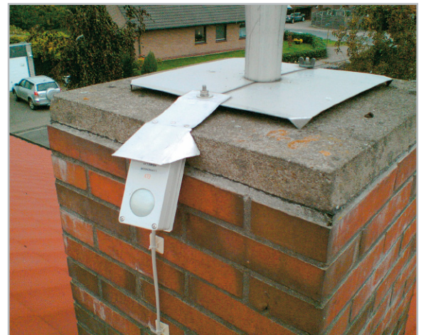
Bild 5: Der Helligkeits-Sensor HS485 LX1 hat einen optimalen, nicht abgeschatteten Standort am Schornstein gefunden.
