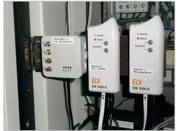
Bild 4: Über das Schaltmodul FS20 SM4 sind Funk-Taster, Bewegungsmelder und Thermostat angekoppelt. Daneben noch die Sendeeinheiten für das Energieerfassungssystem EM 1000.
