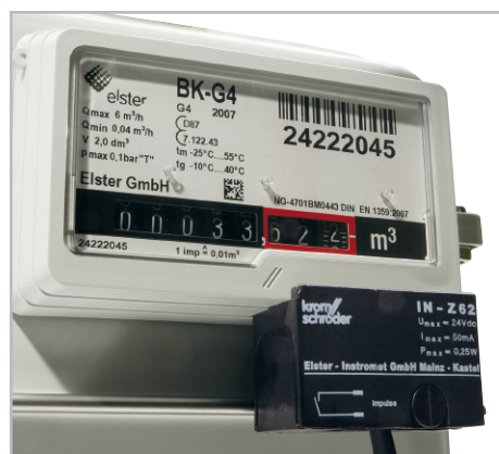
Bild 2: Am Gaszähler befestigter Impulsnehmer
