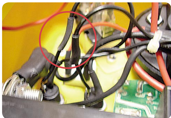
Bild 2: Gefährlich locker sitzende Isolierungen in der Verkabelung
