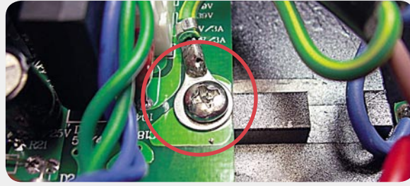
Bild 3: Schutzleiter falsch angeschlossen – keine sichere Erdung!
