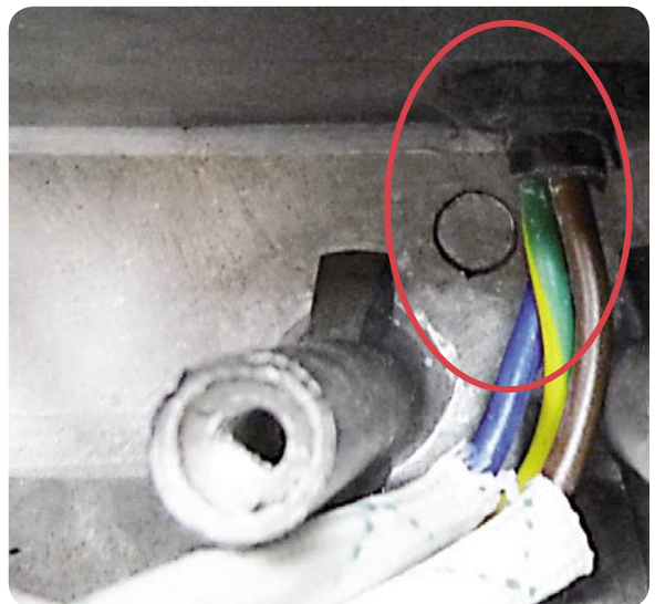
Bild 3: Gefährlich: Netzkabeleinführung ohne Zugentlastung
