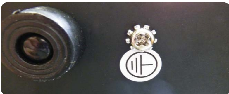
Bild 7: Auch von außen gut markiert und gesichert – die Erdung
