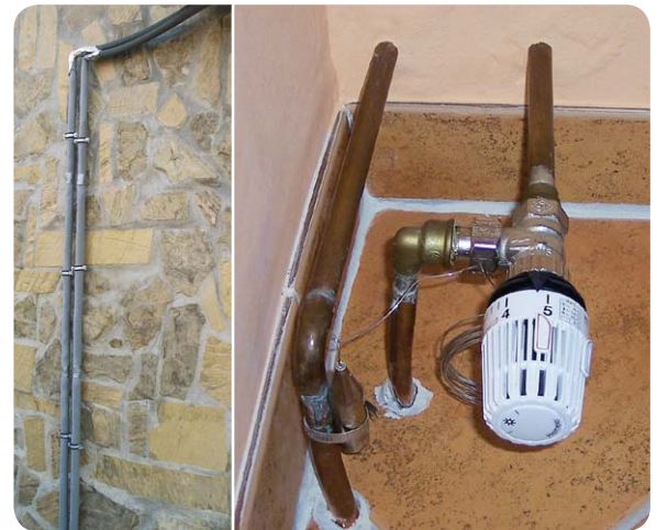
Bild 6: Die Installation im Anbau mit der Rücklauf-Regelung
