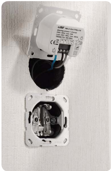
Bild 20: Der fertig verkabelte Dimmer ...
