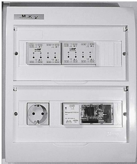
Bild 5: Genug Reserve für die komplette Umrüstung – die Schaltaktoren finden in einem Verteilergehäuse ihren Platz.
