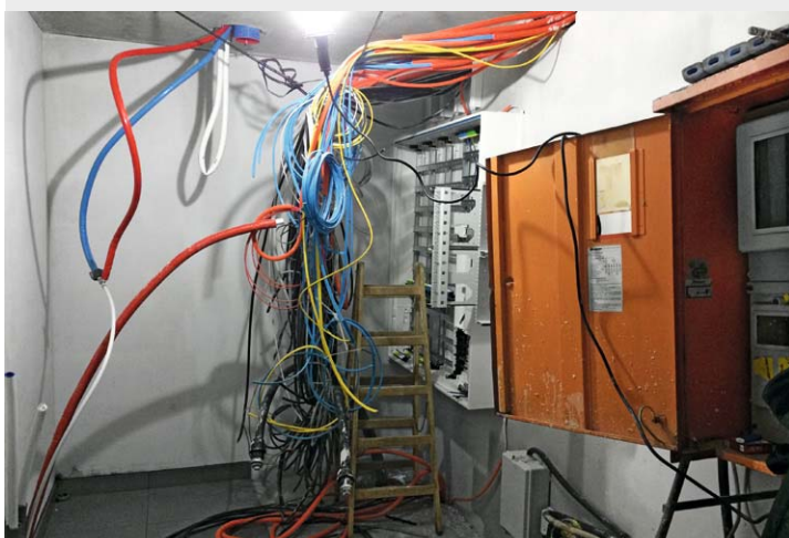
Bild 9: (Fast) eine normale Elektrobaustelle – Impressionen der Elektroinstallation. Man erkennt die sternförmige Verteilung.
