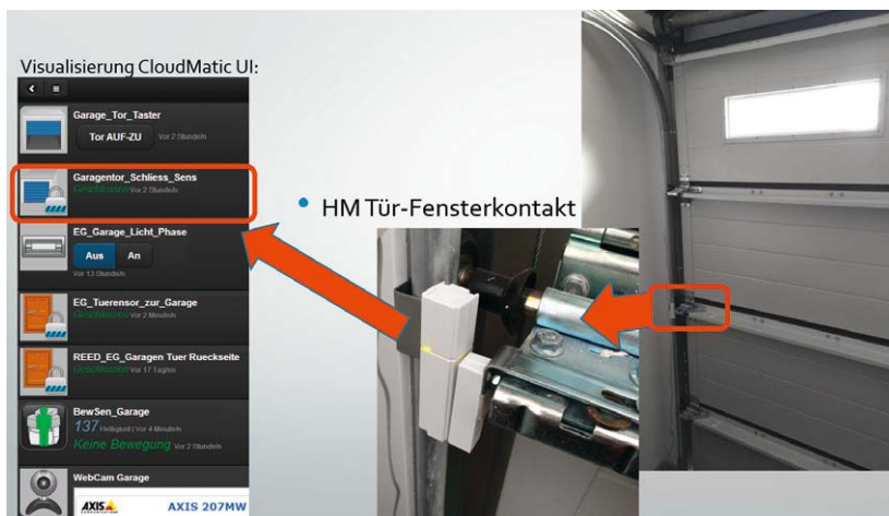
Bild 15: Einsatzbeispiel „Abfrage des Garagenor-Schließzustands“, realisiert mit einem HomeMatic-Tür-/Fensterkontakt
