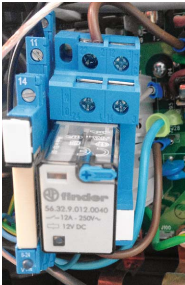
Bild 3: Steckbrücke und nachgerüstetes Finder-Relais für die Heizung
