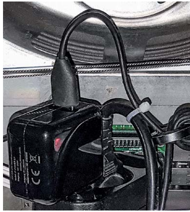
Bild 11: Das Display wird über ein eigenes 5-V-Netzteil versorgt.
