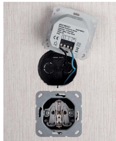
Bild 15: Der fertig verkabelte Wandsender ...
