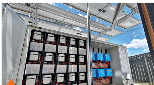
52 Akkumulatoren, Teil 5 Der Redox-Flow-Akku und seine großtechnische Anwendung sowie ein Ausblick auf neue Akkutechnologien
