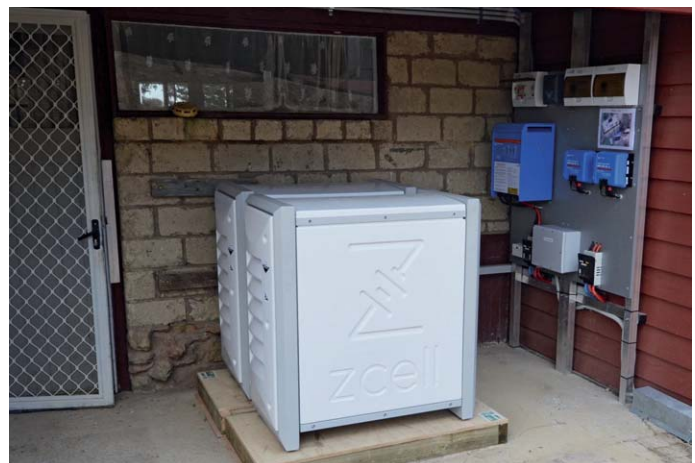
Bild 7: Kompakte Redox-Flow-Einheit an einer privaten Solaranlage mit zwei ZCell-Einheiten. Bild: Redflow
