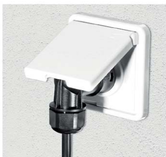
Bild 5: So erfolgt in den meisten Fällen die Einspeisung mit Sicherheitsstecker und Einspeisesteckdose. Bilder: WIELAND Electric GmbH
