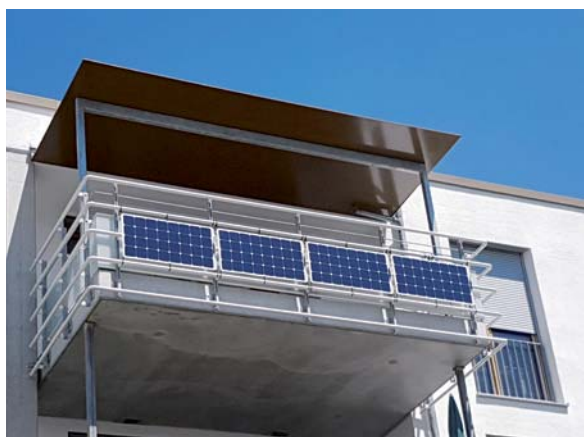
Bild 16: Typisches Balkonkraftwerk mit Montage der Solarmodule in der Balkonbrüstung, Bild: Energieagentur Kreis Konstanz
