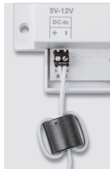
Bild 18: Der Ferritring in der Zuleitung verhindert die Beeinflussung durch Störsignale.
