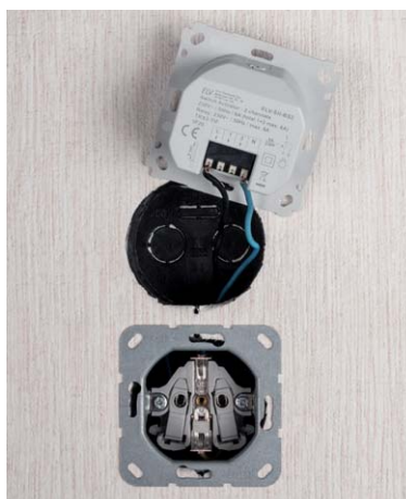
Bild 15: Der fertig verkabelte Wandsender ...
