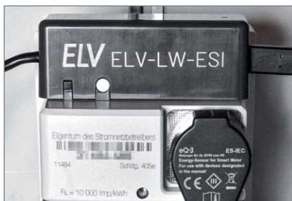
Anwendungsbeispiel mit Stromzähler
