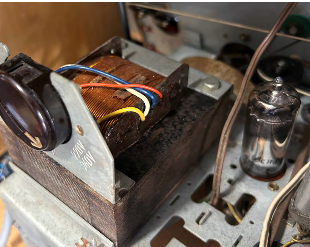
Bild 1: Netztransformator auf dem Chassis eines Graetz Melodia
